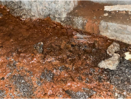
Vann som renner inn i krypkjeller.
