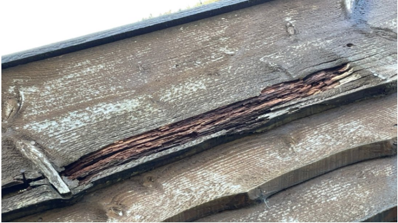
Råteskade på vindskibord.
